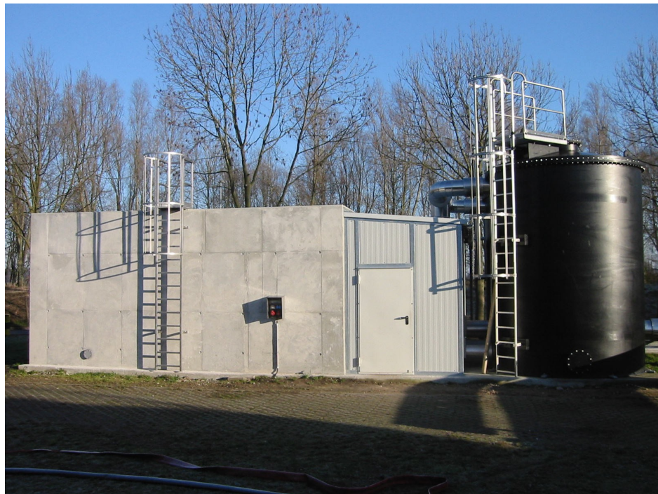
Biowäscher-Biofilter-Kombination zur Reinigung hoch belasteter Klärwerksabluft
